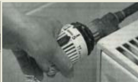
Hauptsache warm. Doch vielen Hausbesitzern ist nicht bewusst, dass sich nur mit gut aufeinander abgestimmten Heizkesseln und Brennern Energie einsparen lässt.
