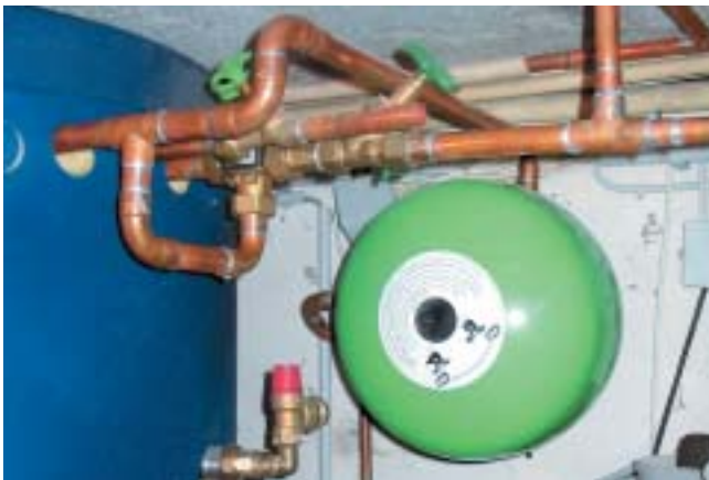
Häufiger Ausführungsfehler: Fehlende Wärmedämmung
