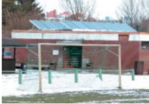
Thermische Solaranlage für einen Sportverein
