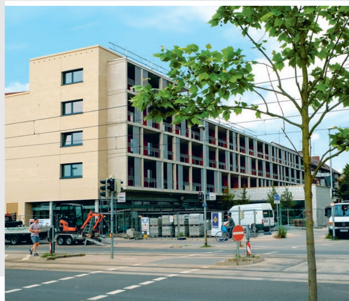
Fertiggestellt: 23 barrierefrei erschlossene Wohnungen und eine WG für Rollstuhlfahrer, dazu ein Stadtteilcafé. Die Hanova gestaltet mit dem Passivhaus-Projekt den Hainholzer Markt neu.
