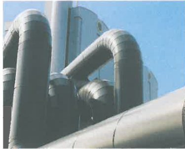
hier: Fernwärmeleitung Stöcken
