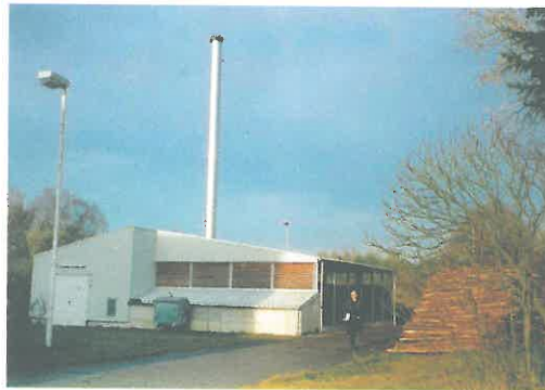
hier: Holzfeuerungsanlage am Wasserwerk Fuhrberg
