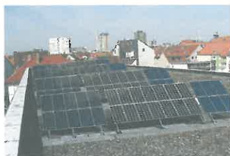
Photovoltaikanlage Amt für Gemeindedienst
